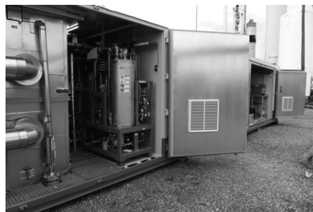
Abbildung 6. Inbetriebnahme der LOHC-Anlage bei der United Hydrogen Group (Tennessee, USA). © Hydrogenious Technologies GmbH.
